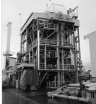
Kogenerační stanice na zplynování dřeva v rakouském Güssingu.
